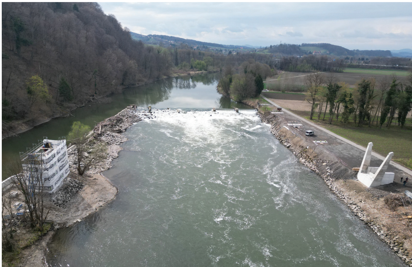
Slika 5. Zaopazen opornik (SLO) in izveden opornik (AUT), plato za montažo nosilcev (marec 2025).
