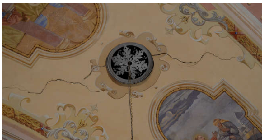
Slika 2: Razpoke na stropu ladje (vir: Gorazd Prašnikar).
