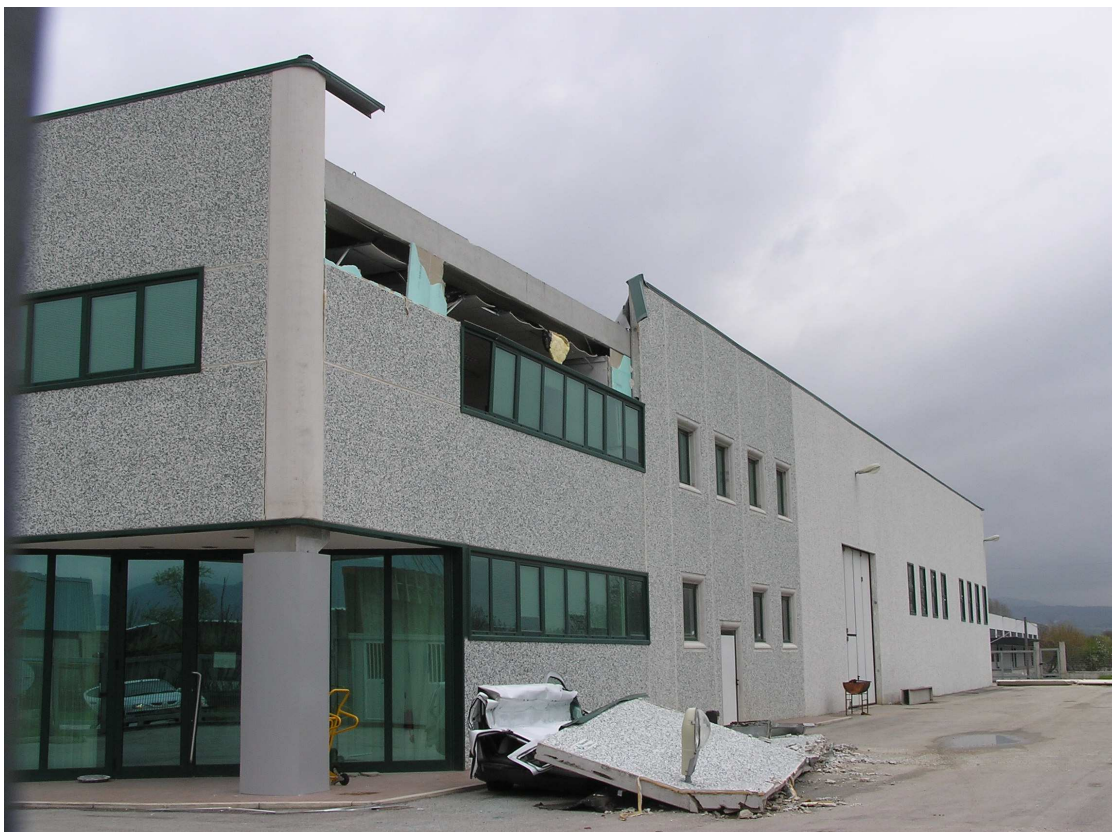
Slika 7. V novem delu vasi Monticchio je prišlo do poškodb tudi na novih industrijskih objektih grajenih na seizmo-geološko slabših tleh (foto: I. CeciĆ).
