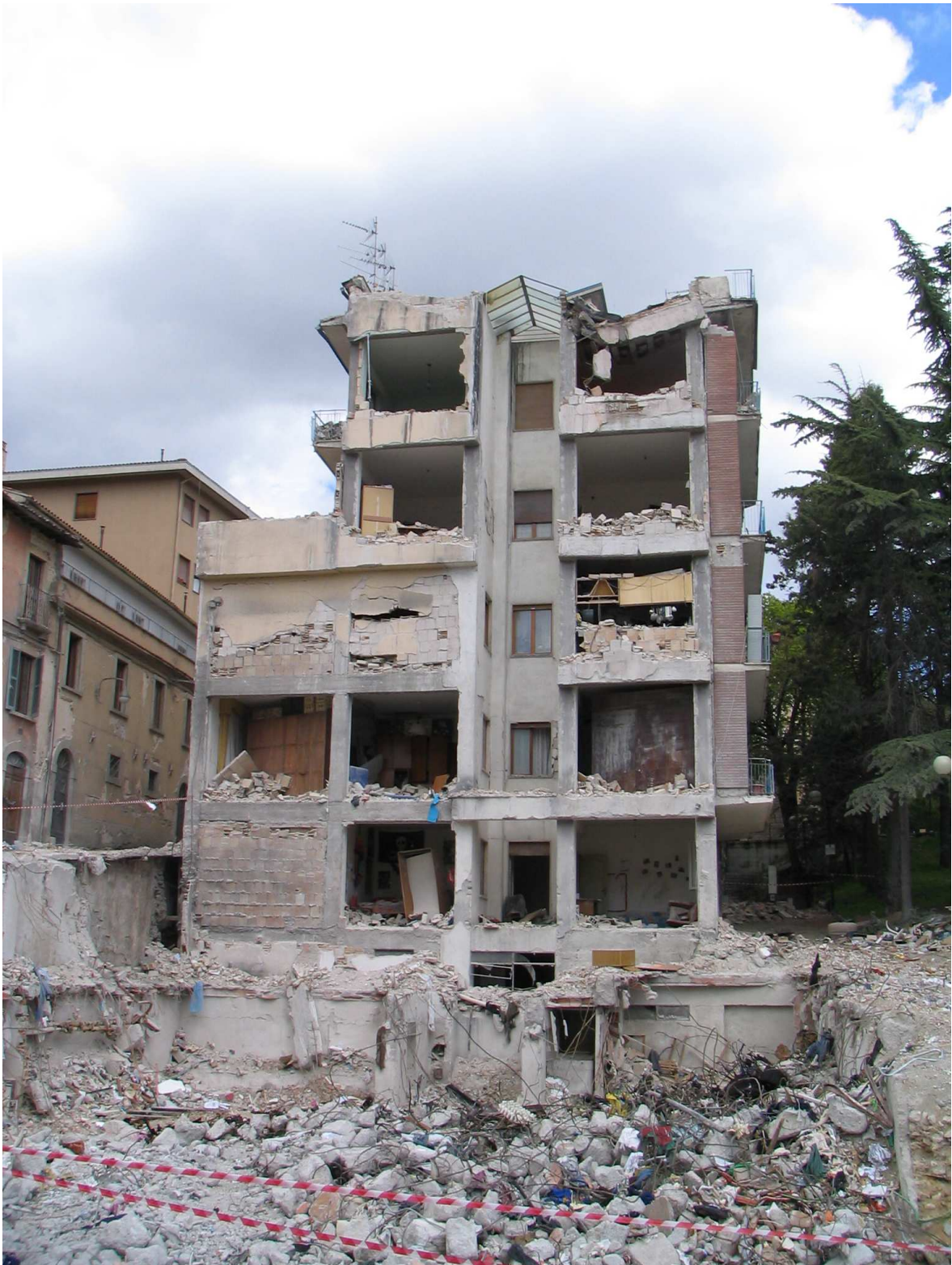
Slika 3. Pred poškodovanim petnadstropnim objektom v širšem centru L'Aquile je stal 7 etažni objekt zgrajen v letih med 1960 in 1970, ki se je popolnoma porušil. Porušeni objekt je bil tudi armirani betonski okvir. Uporabljena je bila gladka armatura, stremena pa so bila redka. (Foto: M.Godec)
